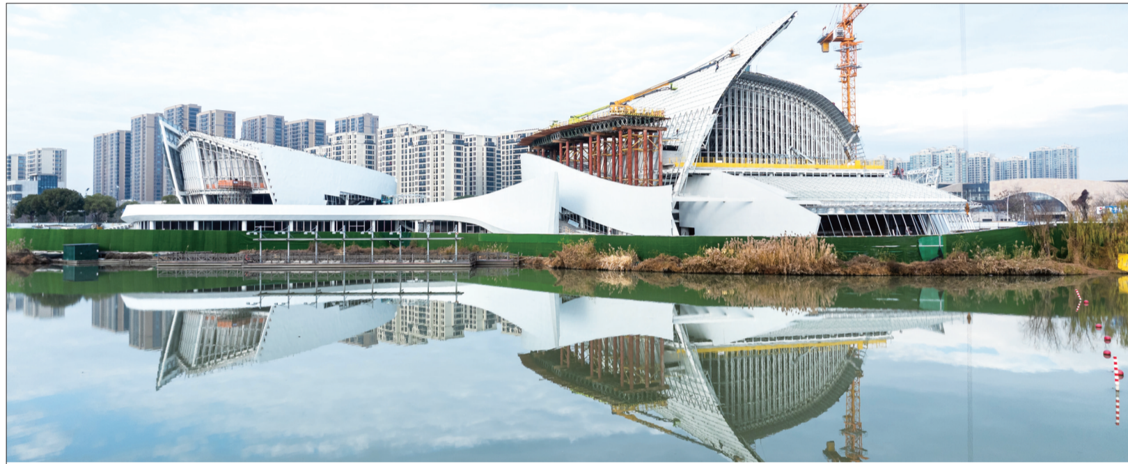
昨天,在明湖科创文化园项目现场,多台吊机联合作业,工作人员正在对外立面幕墙铝板进行安装。据介绍,该项目地下地上粗装饰已完成,目前正在进行室内机电安装、装饰装修等专业工程以及室外附属配套施工。 ■摄影 王强 董明跃
